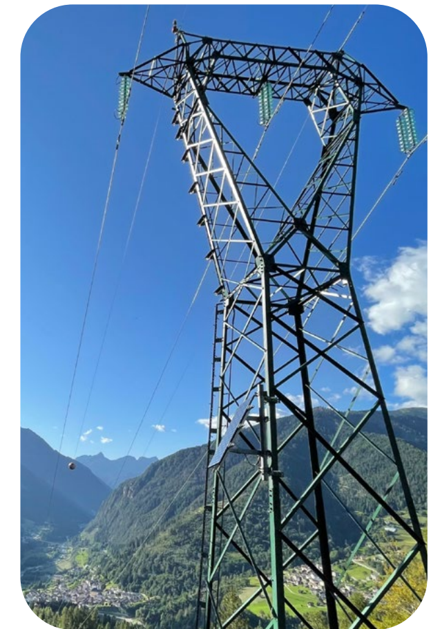
Linea di alta tensione nella Valle del Vanoi
