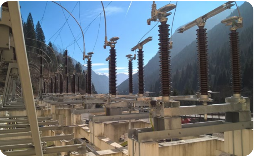
Stazione dell'alta tensione della Centrale di Caoria
