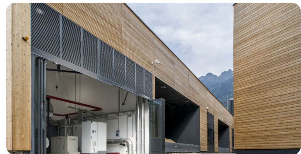
Centrale di Teleriscaldamento di Primiero
